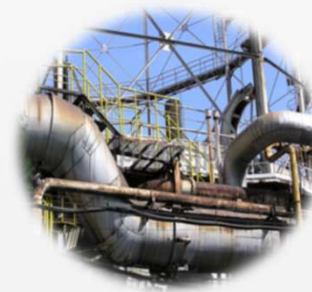
プラント設備
