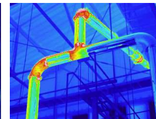
配管の断熱材劣化
