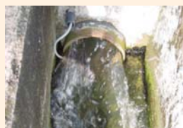
排水溝流量モニタ
